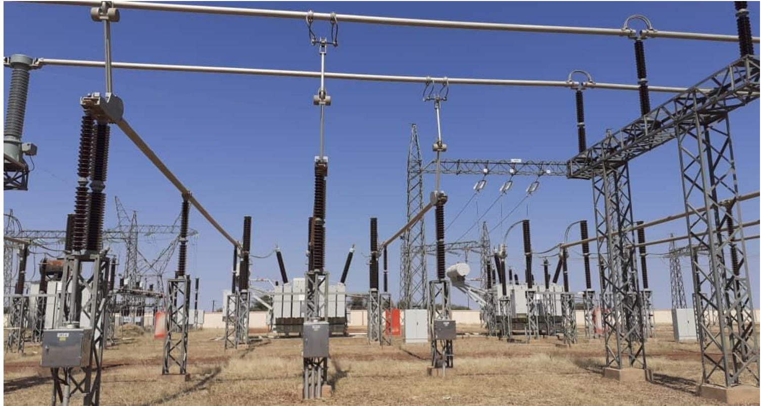
Photo 1 : Matam Travée TR-20 MVA existante
